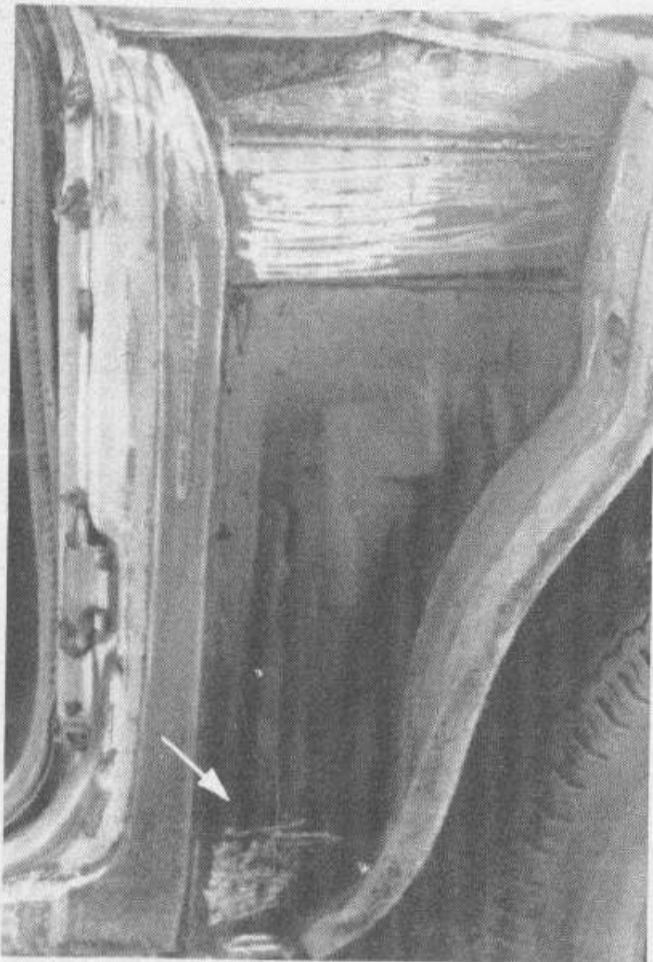
Bild 1-30 Hohlraum hinter dem Schottblech im vorderen Radkasten des Lada; Vorschlag: Profil unten zum Wasserablauf öffnen
